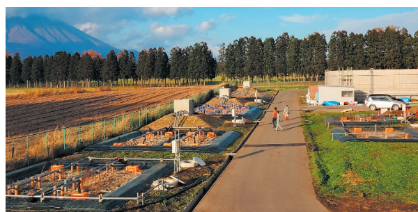
写真2 雫石の人工湿地排水処理システム
