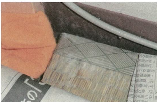
写真2 結露・カビ被害 (OF_E)
