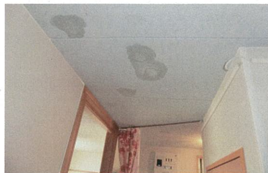
写真3 小屋裏結露によるシミ (OT_W)
