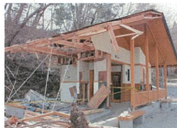
写真1 浄土ヶ浜トイレの破損状況
