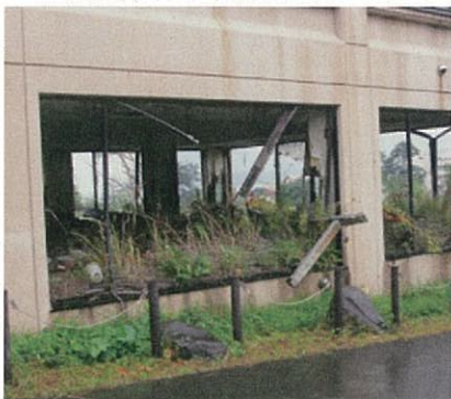
写真5 洞爺湖温泉 泥流によって破壊された公共温泉施設の内部。建物の中がそのまま残されている。
