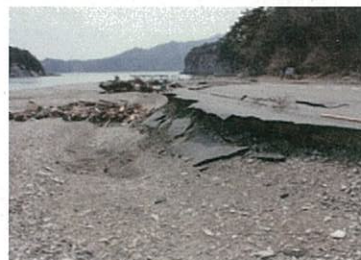
写真2 浄土ヶ浜園地の被災状況
