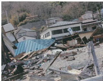
写真9 津波による建物の破壊状況
