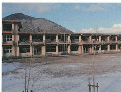
写真7・8 雲仙普賢岳の火砕流によって焼けただけた旧大野木場小学校。室内が当時のまま残されている。
