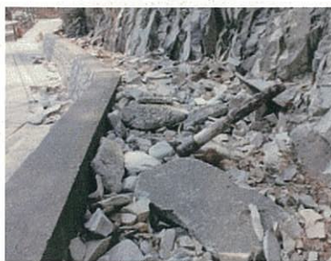
写真3 浄土ヶ浜園地 歩道 の被災状況
