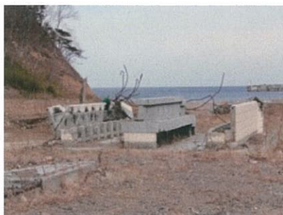
写真10・11 中の浜野営場の震災遺構 炊事場とトイレ
